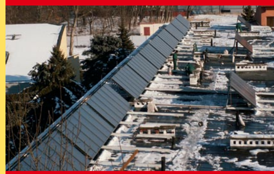
Solary dla Krytej Pływalni na dachu ZS im. W. Witosa w Suchej Beskidzkiej
