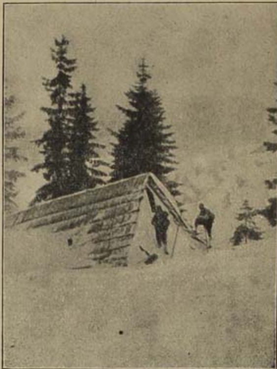
Dach koszarów żandarmeryi zerwany prądem powietrza wytworzonym przez lawinę.
